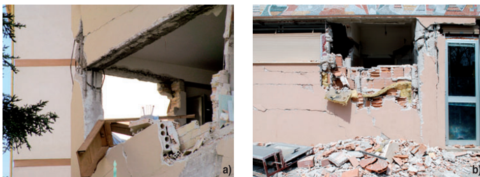
Figura 2.5. L'Aquila, terremoto 6 aprile 2009 – a) edificio di civile abitazione: danneggiamento del nodo trave-pilastro e degli elementi non strutturali; b) edificio scolastico: danneggiamento del pilastro e degli elementi non strutturali
