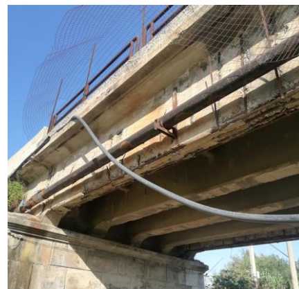
Figura 4 - Ponte Fiumarella Pellaro (RC), Calabria - Impalcato ammalorato.
