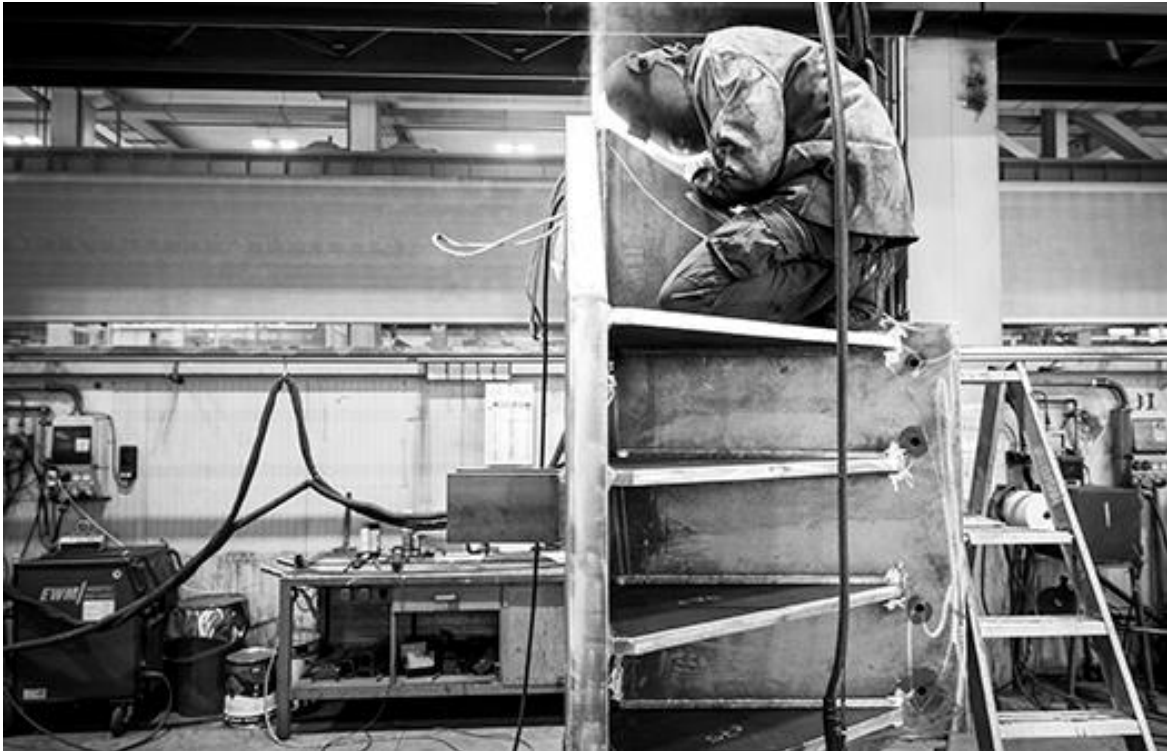
Saldatura in officina di carpenteria metallica – foto: Alex Filz / Stahlbau Pichler srl
