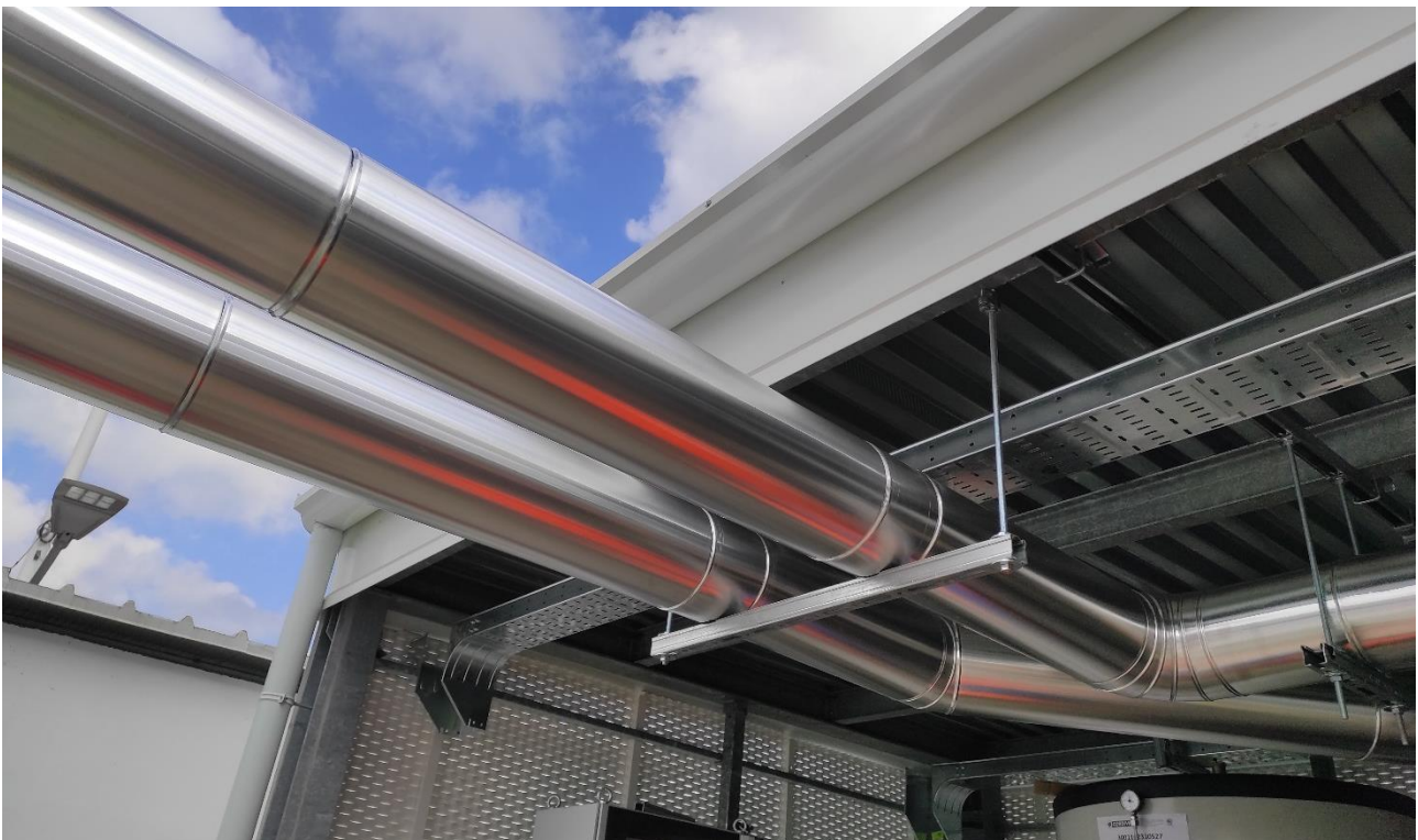
Fig. 2 – Esempio sistema di binari per tubazioni
