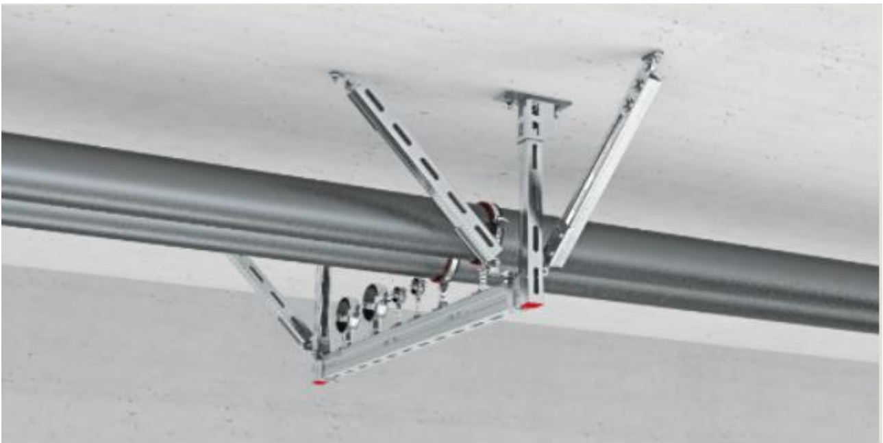
Fig. 18 – Esempio di sistema di binari per fissaggio nel rispetto delle indicazioni per sostegni in zona sismica
