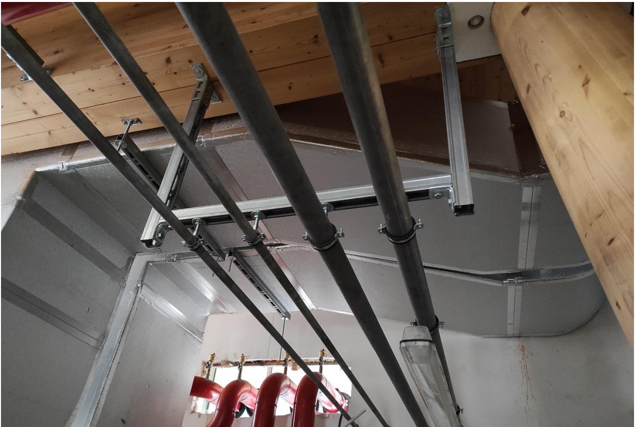
Fig. 17 – Esempio sistema di binari per tubazioni
